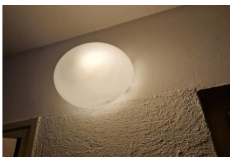
Éclairage parties communes
