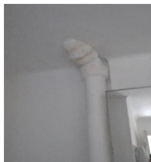
Descente des eaux usées
