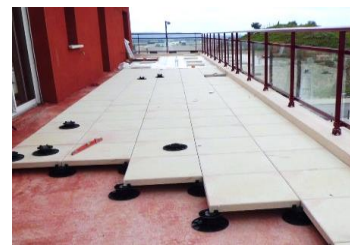
Toiture terrasse avec dalles sur plots
